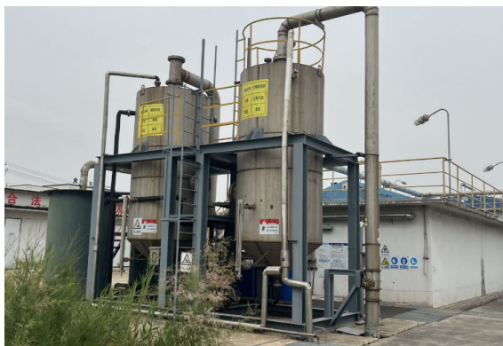
一级碱吸收+生物除臭（预处理）
