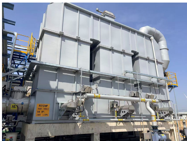
RTO 焚烧系统（主处理）
