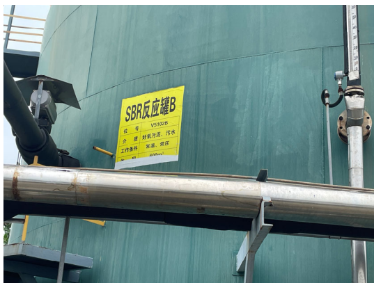
SBR 反应罐 B
