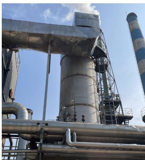
焚烧尾气急冷装置
