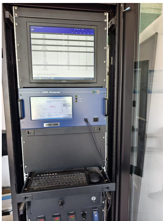
DA002 排气筒废气在线监测（非甲烷总烃）
