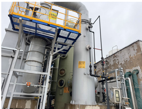
一级水喷淋+一级碱喷淋（后处理）
